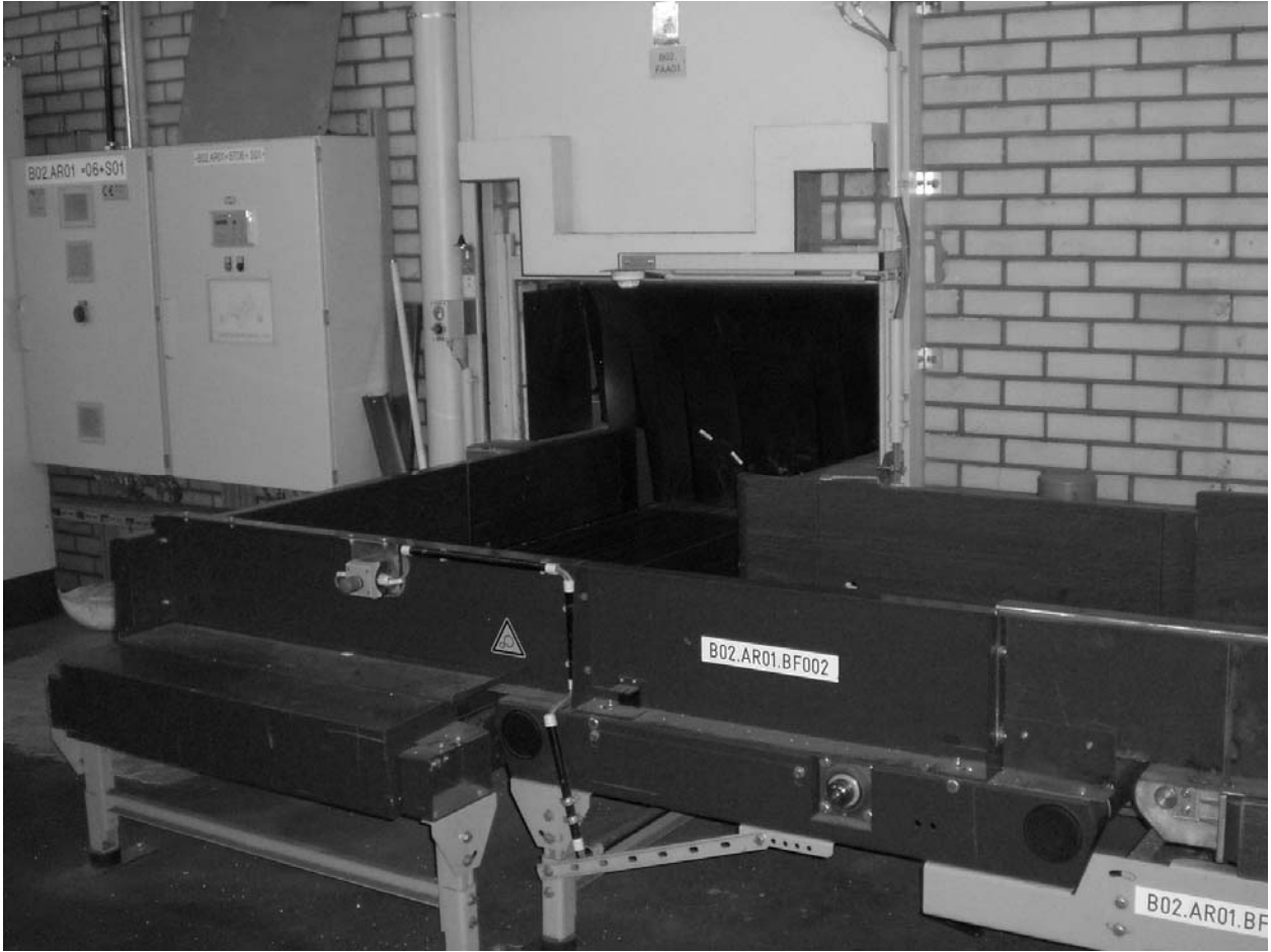
Abb. 18 Gepäckabförderanlage in nur eine Richtung
